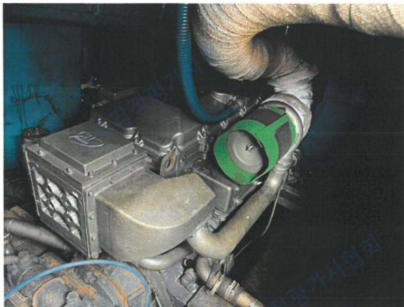
[ 대상물건 주기관 전경 ]
