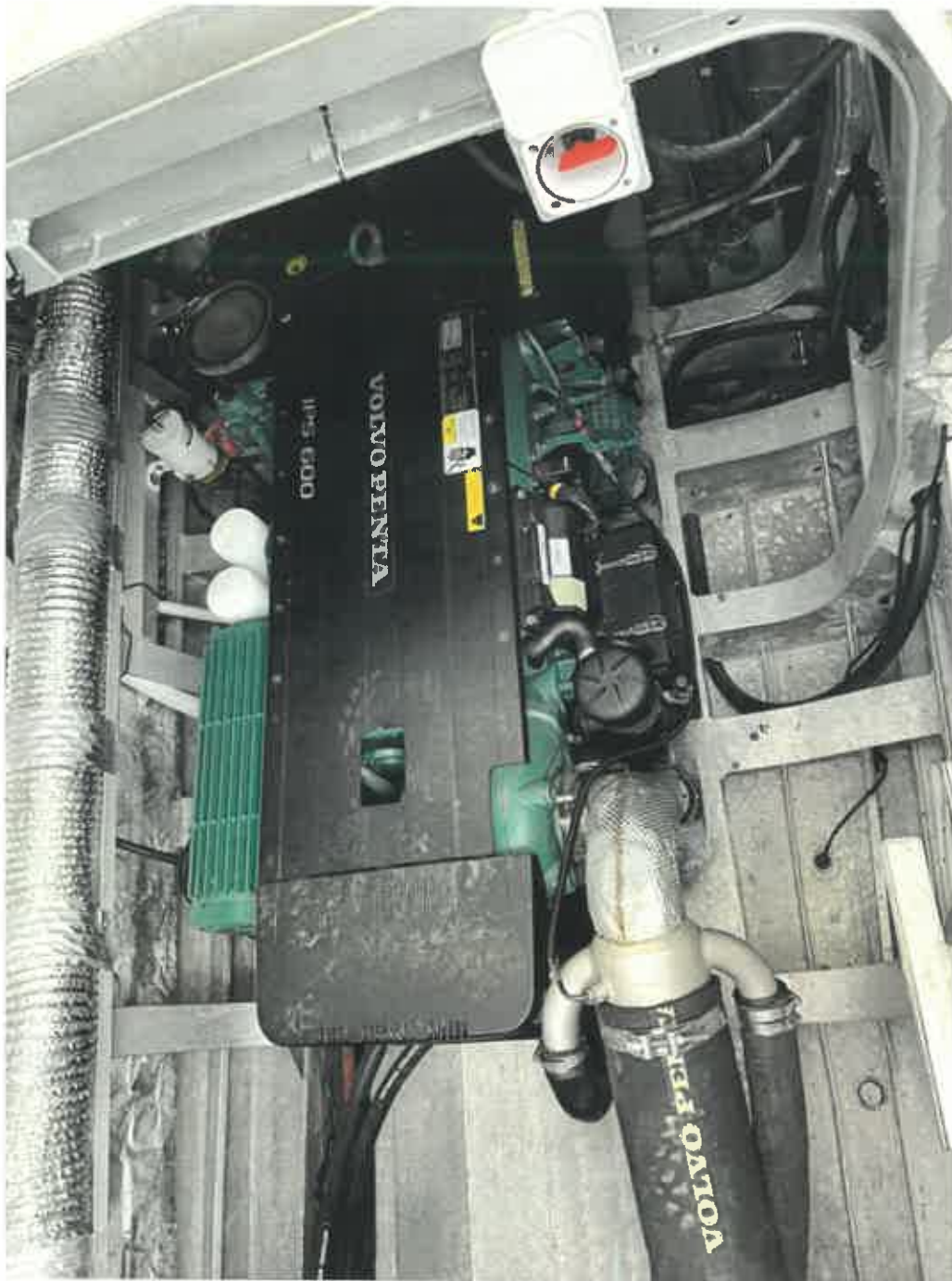
[ 대상물건 주기관2 전경 ]
