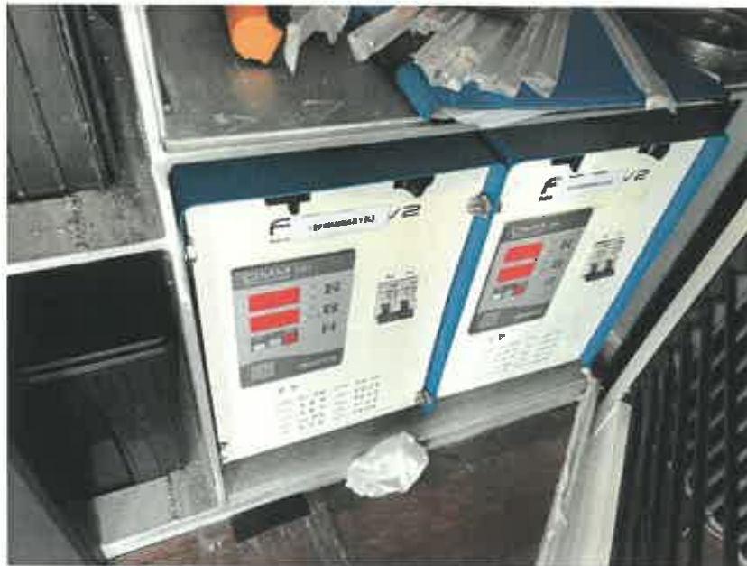
[ 대상물건 배터리 전경 ]
