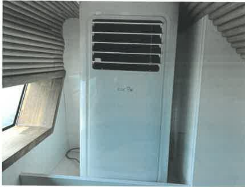
[ 대상물건 의장품 8)(이동식 에어컨) 전경 ]
