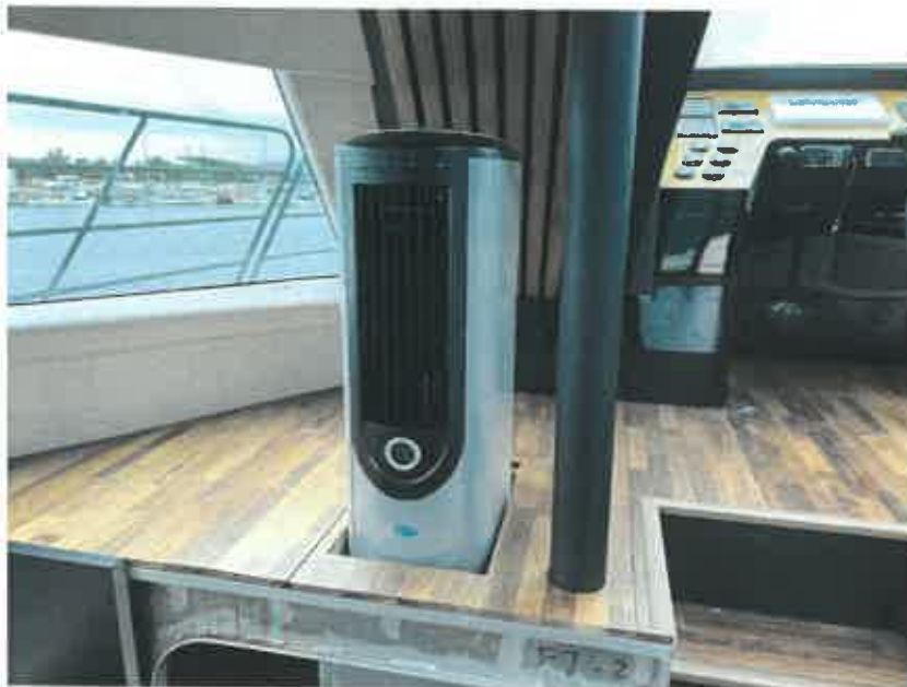
[ 대상물건 의장품 7)(전기냉난방기) 전경 ]
