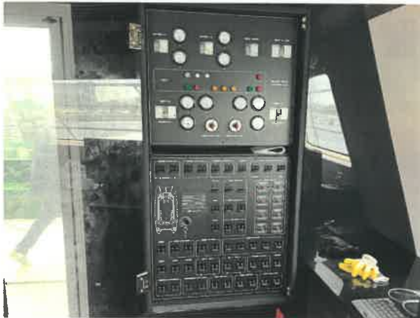
[ 대상물건 배전반 전경 ]
