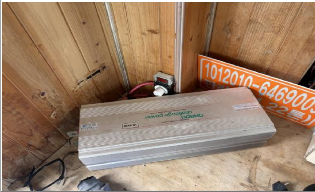
본건 선체부속 전기시설(인버터)
